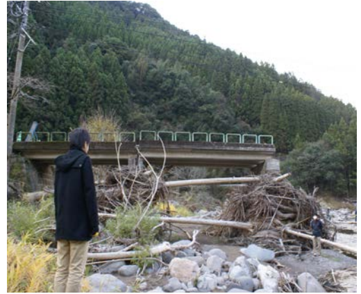
平成24年7月九州北部豪雨における流木による橋梁の被災状況（日田市内高瀬川）
